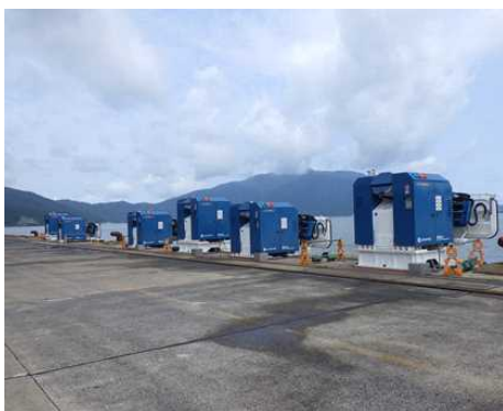
敦賀港の自動係留装置（全6基）
