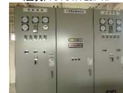
陸電装置(周波数・電圧変換)
