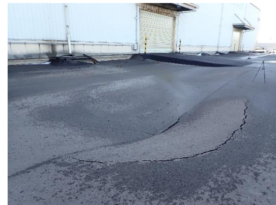
ふ頭用地陥没
