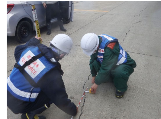
エプロンの亀裂
