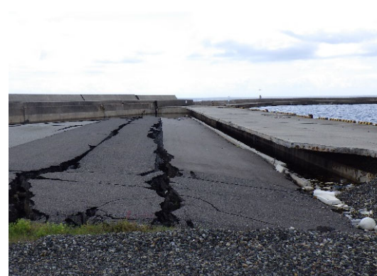
岸壁背後の陥没
