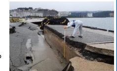
物揚場エプロン沈下(被災後)
