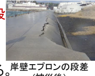
岸壁エプロンの段差(被災後)
