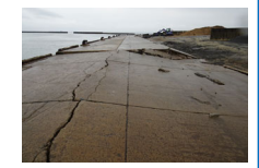
岸壁エプロン沈下(被災後)
