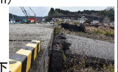
物揚場エプロン段差(被災後)
