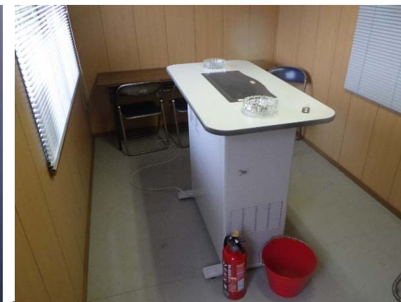
分煙機を導入した喫煙室
