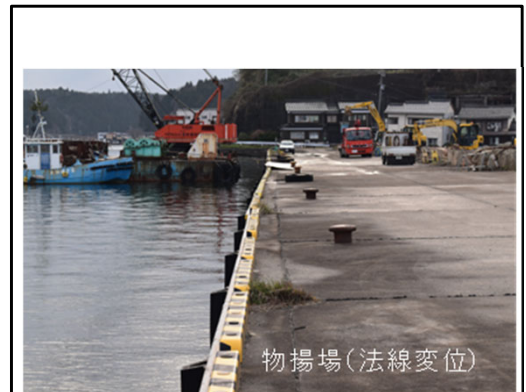
鋼矢板の法線の出入りやエプロン部の沈下が顕著
