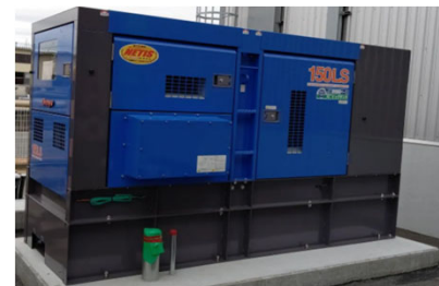
<非常用電源設備>
