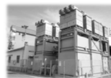
陸電供給設備
