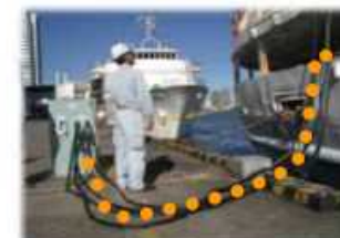
電力供給設備
